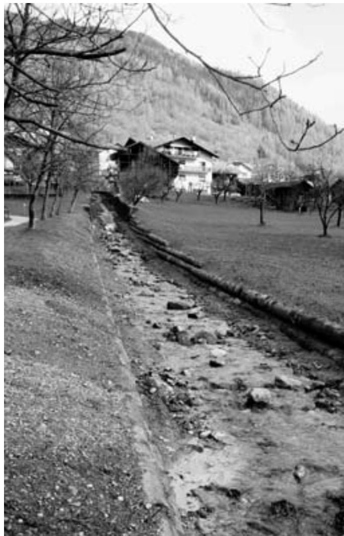
I lavori di sistemazione del Rivo San Pietro nel tratto sottostante via Nazionale, in corso di esecuzione da parte della P.A.T. - Servizio Bacini Montani.
